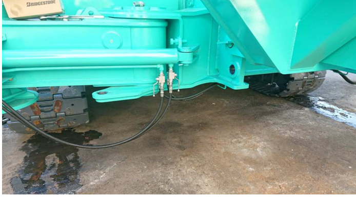
Rジャッキ・スポンナー油圧切替バルブ取付 (油圧ホースを差し替えないようにする目的) 使用部品 3分の3方バルブ×4個+ アダプター各種
